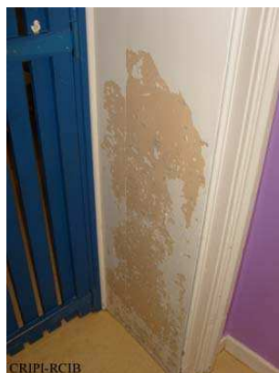
Photo 39.4 : Encadrement recouvert de peinture au plomb écaillée
